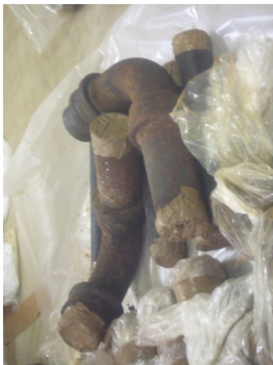
図 3.4.2 -9 接続部に鉛パッキングが使用されている配管
